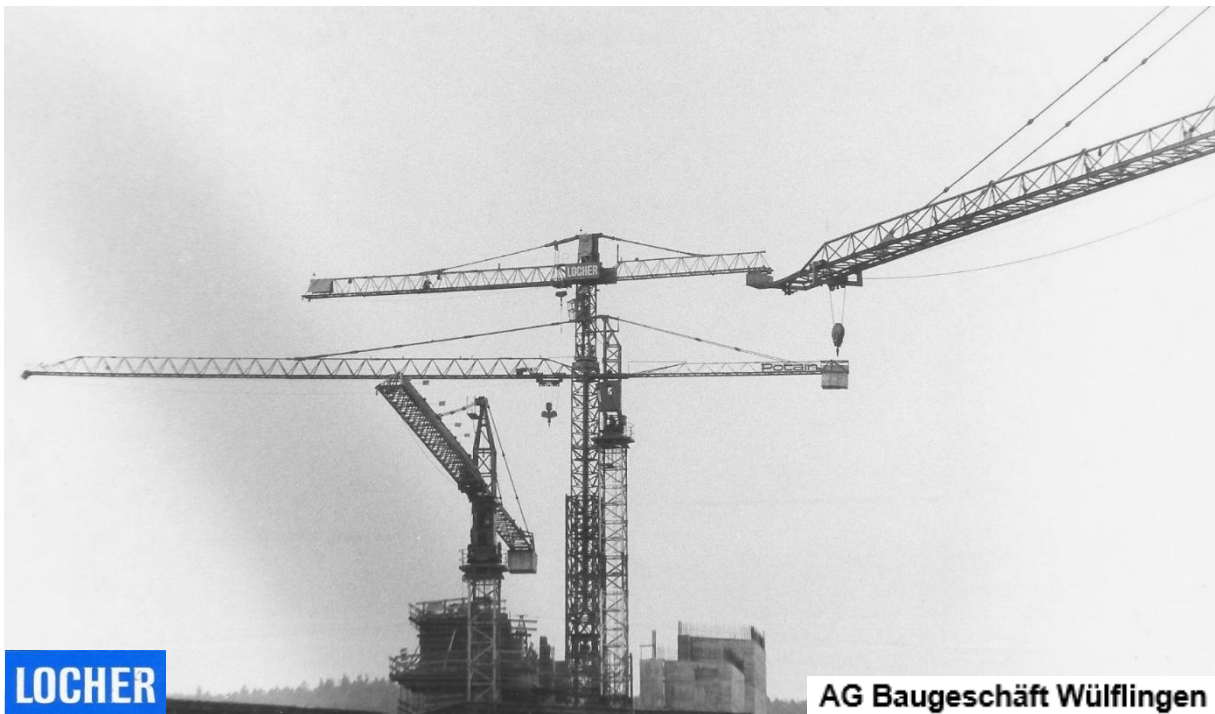
Potain 743 B, Richier- Weitz GT 1174 B, Potain 645 und Ausleger WK 60 S auf der Baustelle des Heizkraftwerks Aubrugg. Aufgenommen von Pius Meyer im August 1976.
