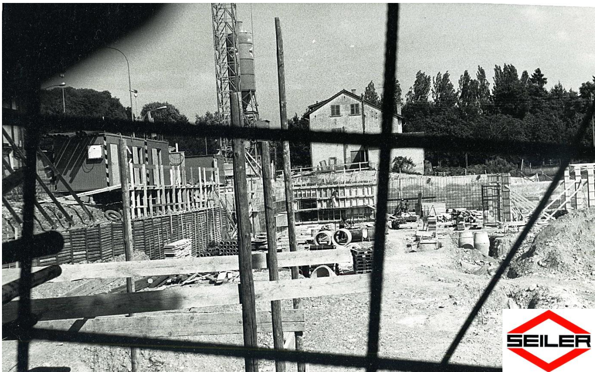
Blick in die Baugrube der Zentrumsbaustelle der Firma Seiler, Sommer 1977. Foto Pius Meyer.
