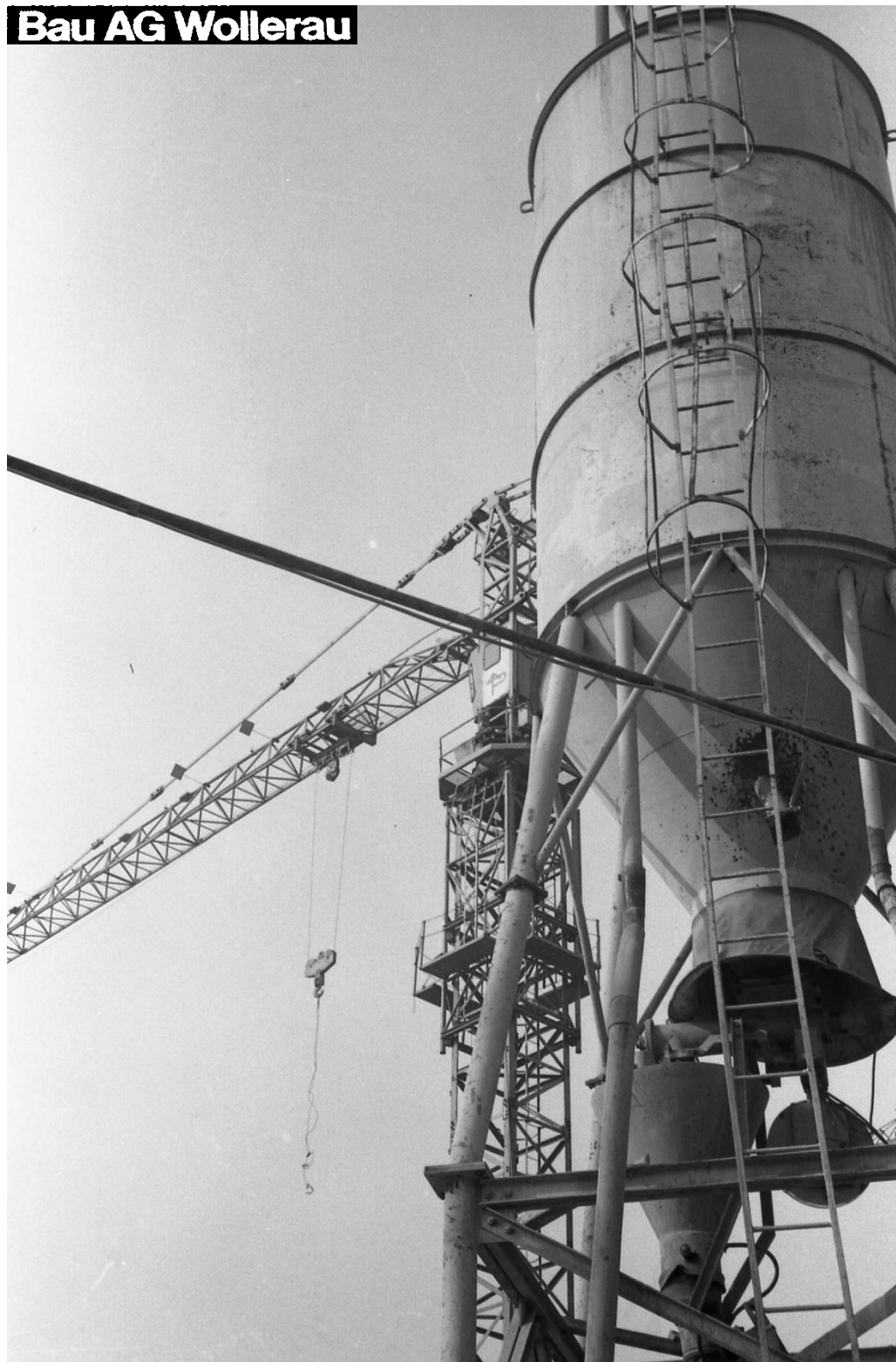
Potain 645 der Firma Bau AG Wollerau. Neubau der Metzgerei Niedermann im Industriegebiet Rietbach 1972. Foto Pius Meyer.
