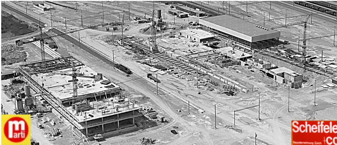
Links die beiden Wolff WK 90 SL-O der Firma Marti AG Zürich, rechts davon die beiden +Swiss-Crane+ der Firma Scheifele. Foto SBB Historik 1974.
