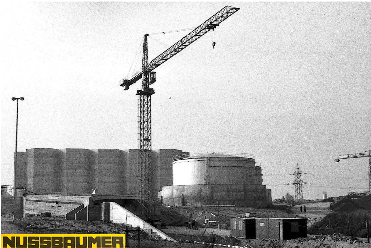
Das fertiggestellte Heizkraftwerk 1978. Im Vordergrund eine Brückenbaustelle auf dem Trasse der künftigen Autobahn. Eingesetzter Kran +Swiss-Crane+ TKF 801 der Firma Nussbaumer aus Wallisellen. Foto Pius Meyer.
